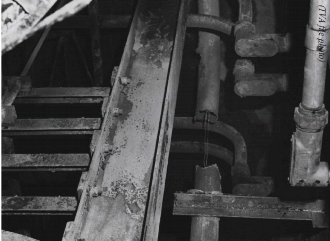
Ilustración 10: Imagen de Browns Ferry después de incendio (bandeja de cables y conduits) (54)
